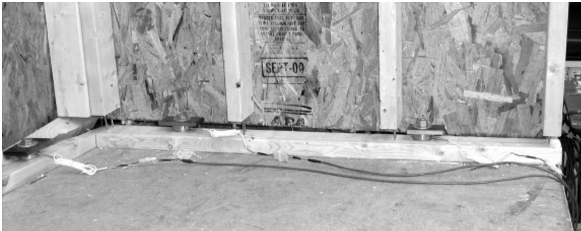
FIGURE 9 CORNER RETURN FAILURE (Wall 6)
