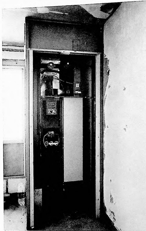
O. HVAC unit
